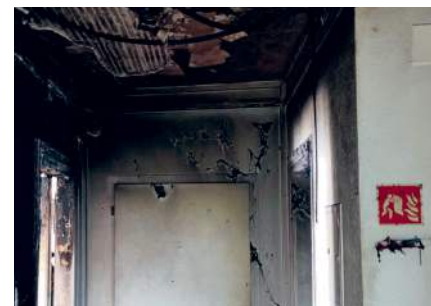
Das falsch geschaltete Ladegerät eines E-Scooters führte dazu, dass der erste Stock des Wohnangebots Waffenplatz45 erheblich beschädigt wurde.
